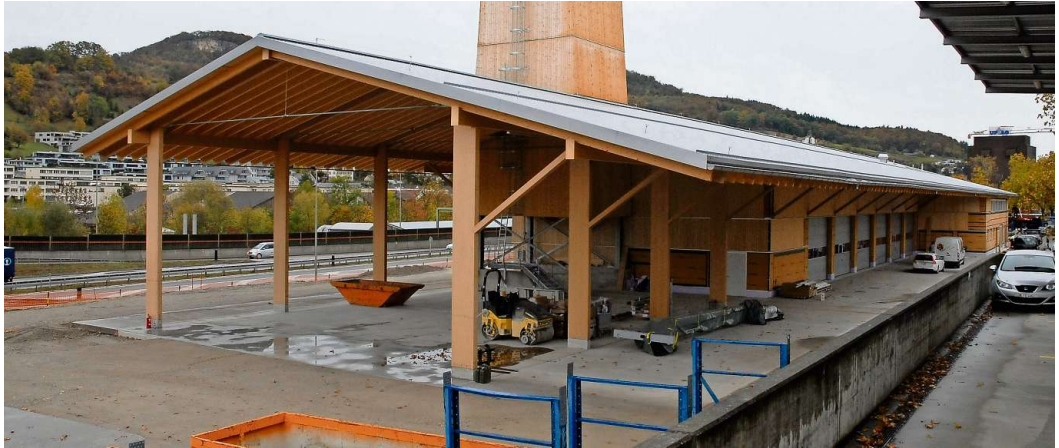
Zu geringe Nutzlast. Bei Schneefall und montierten Solarpanels könnte das Werkhofdach des Holzbaus einstürzen. Foto Christian Horisberger
